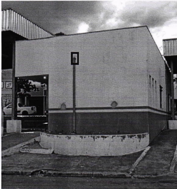
Figura 02: Vista frontal da rodoviária, e localização de uma das saídas da calha a ser substituída.
