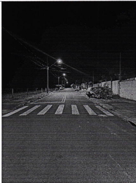
F15 – Luminárias de LED instaladas na Rua Arvelino Marmentini (noite)
