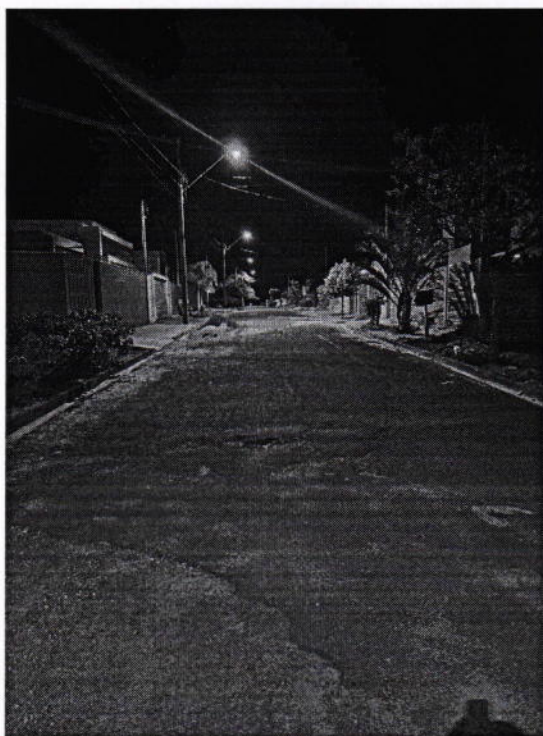
F09 – Luminárias de LED instaladas na Rua Hermez Caparroz (noite)
